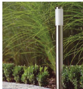
illuminazione camminamenti condominiale
